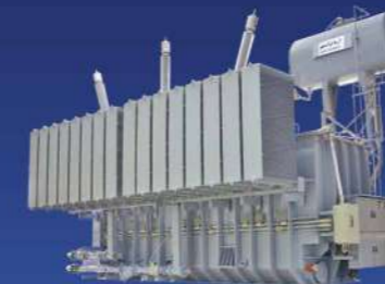
ترانسفورماتور نیروگاه سیکل ترکیبی دو کوهه توان 385 MVA، ولتاژ 20/245 kV
