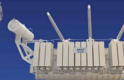
ترانسفورماتور قدرت مجتمع صنعتی و معدنی گل‌کهر سیرجان توان 270 MVA، ولتاژ 400/33 kV
