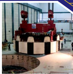
بهینه‌سازی تجهیزات توربین ژنراتور واحد شماره ۳ نیروگاه سد شهید عباسپور
