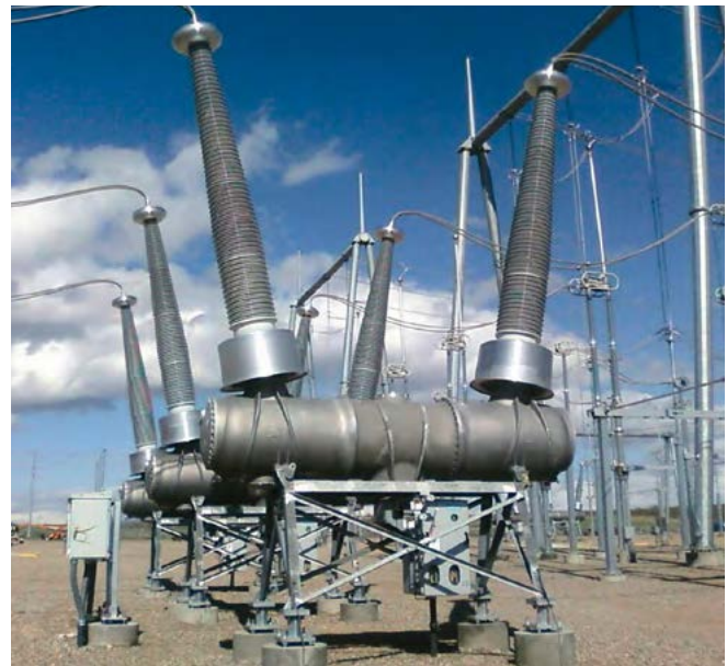
Fig. 4.1-15: 3AP2 DT 550 kV
