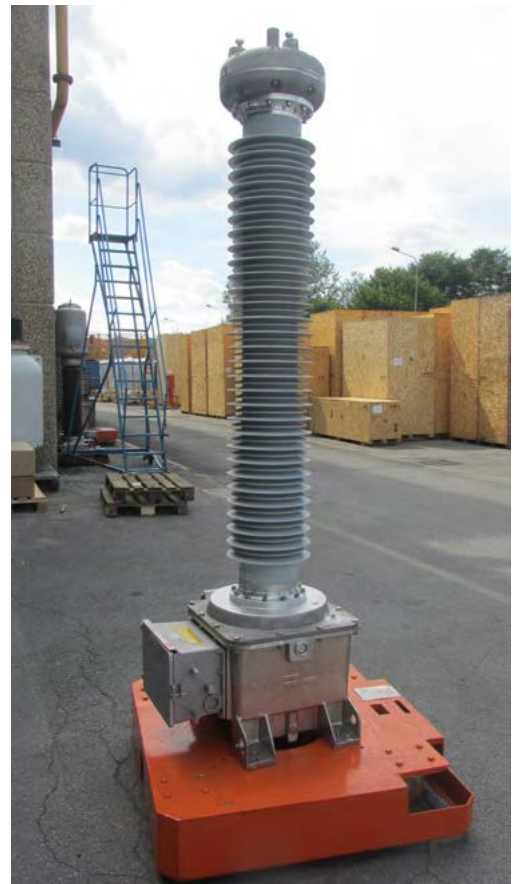
Fig. 4.2-25: 170 kV MoW (RTCVT)
