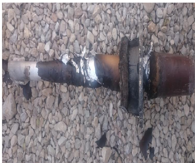
شکل (۵): شروع حادثه با انفجار پوشینگ سمت HV ترانس
