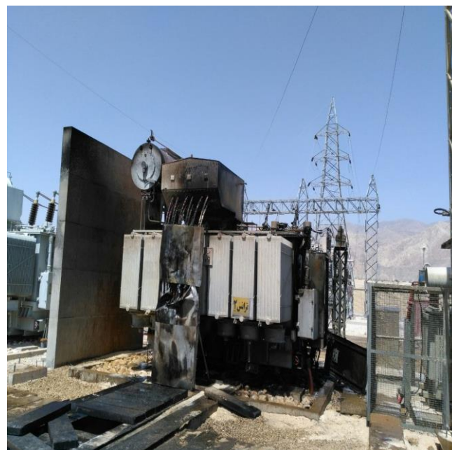
شکل (۴): ترانسفورماتور بعد از حادثه
