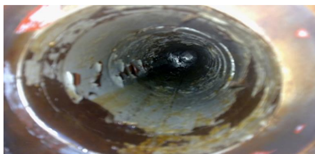
شکل ۶: کلکتور معیوب و پوسیده ۶ رادیاتور ترانسفورماتور
