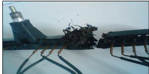
شکل ۶: اتصال مکانیکی مکانیزم عملکرد تپ‌چنجر با دو فاز
