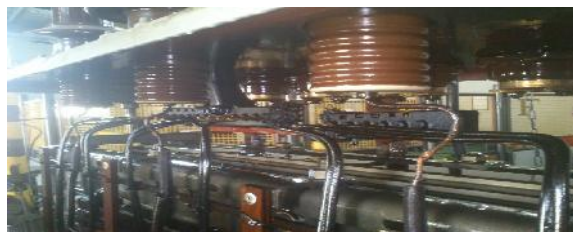
شکل ۲: گسستگی تپ‌چنجر ترانسفورماتور 500kva
