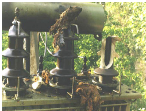
تصویر شماره 2 - افتادن پرندگان بر روی تجهیزات هوایی
